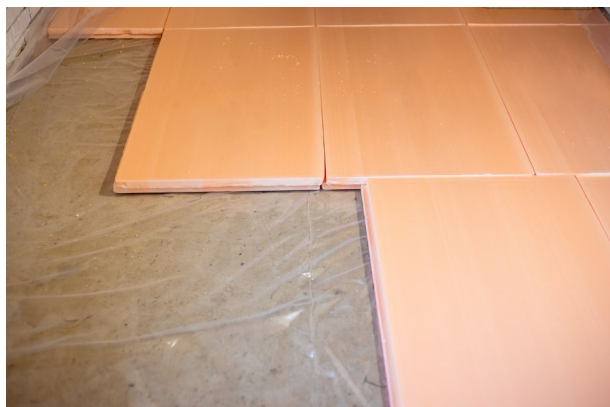
Aislantes XPS con barrera antihumedad debajo
