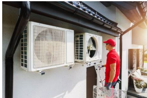
Revisión de la unidad exterior
