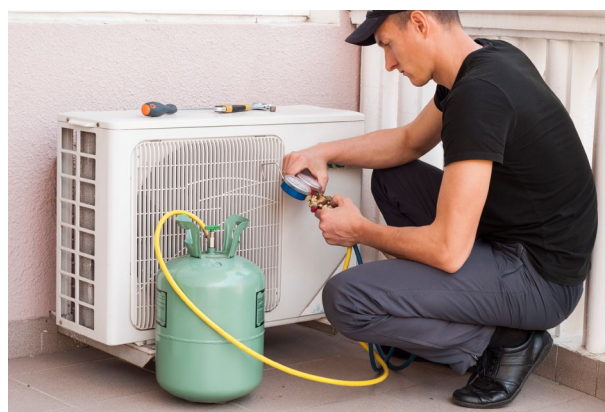
Recarga de refrigerante
