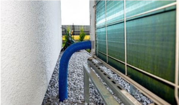
Desagüe de condensados
