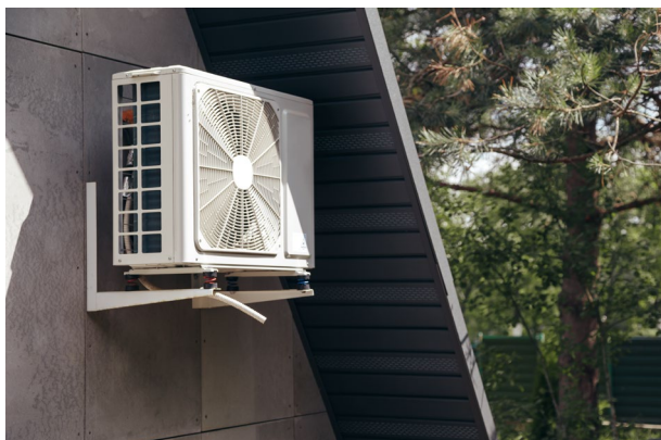
Tubo de evacuación de condensados
