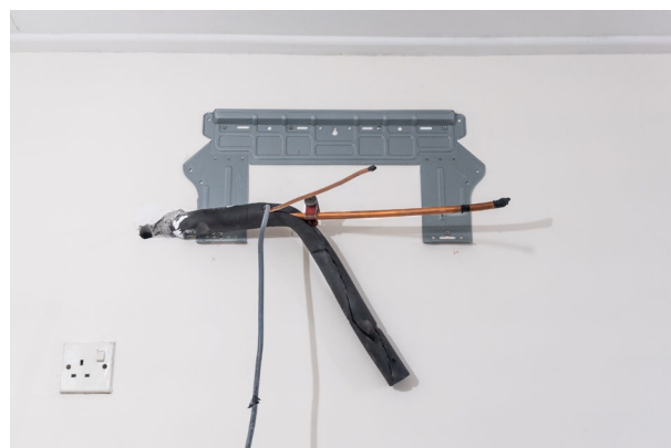
Paso de tuberías y cables hacia el exterior
