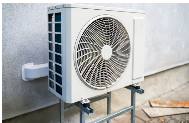
Unidad exterior sobre bancada nivelada
