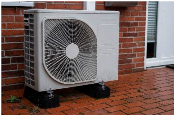
Unidad exterior colocada sobre soportes antivibratorios
